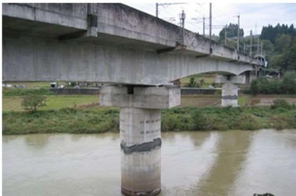
図7 魚野川にかかる新幹線の橋脚に発生した曲剪断破壊（地団研専報原図）
