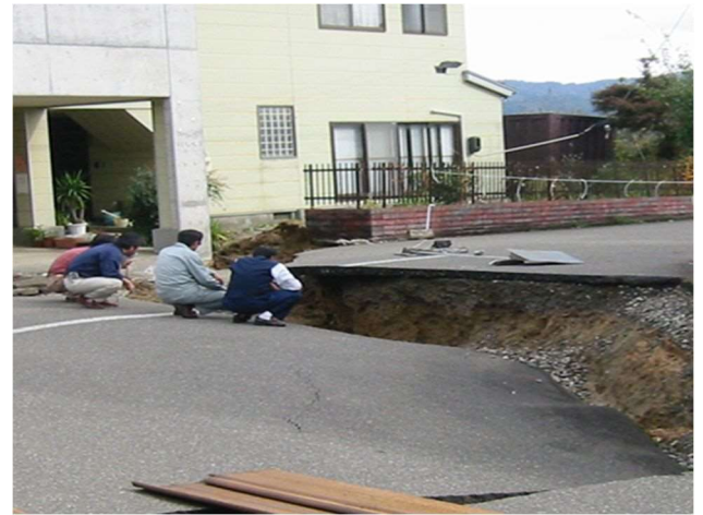
図 12 団地北西部における盛土の水平変位にともなう開口亀裂
