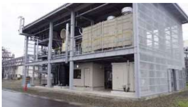
図 12 メタネーション試験設備(長岡)
