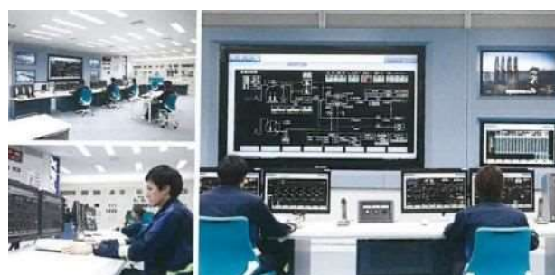
図 11 中央制御棟 (中央操作室)
