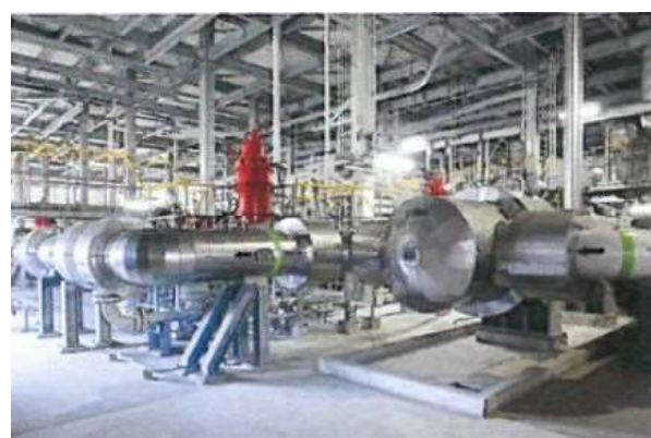
図 10 熱量調整設備
