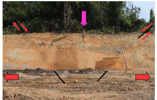
図 3 巻町の宅地造成地に見られた断層の露頭
