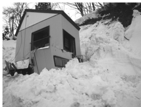
図3 地震による雪崩によって被災した建物（新潟県十日町市）
