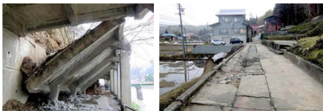
写真-7 横倉地区の道路施設被害
