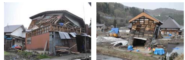
写真-5 青倉地区の家屋被害
