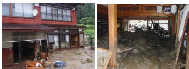
図-10 土石流が直撃した人家の被害
